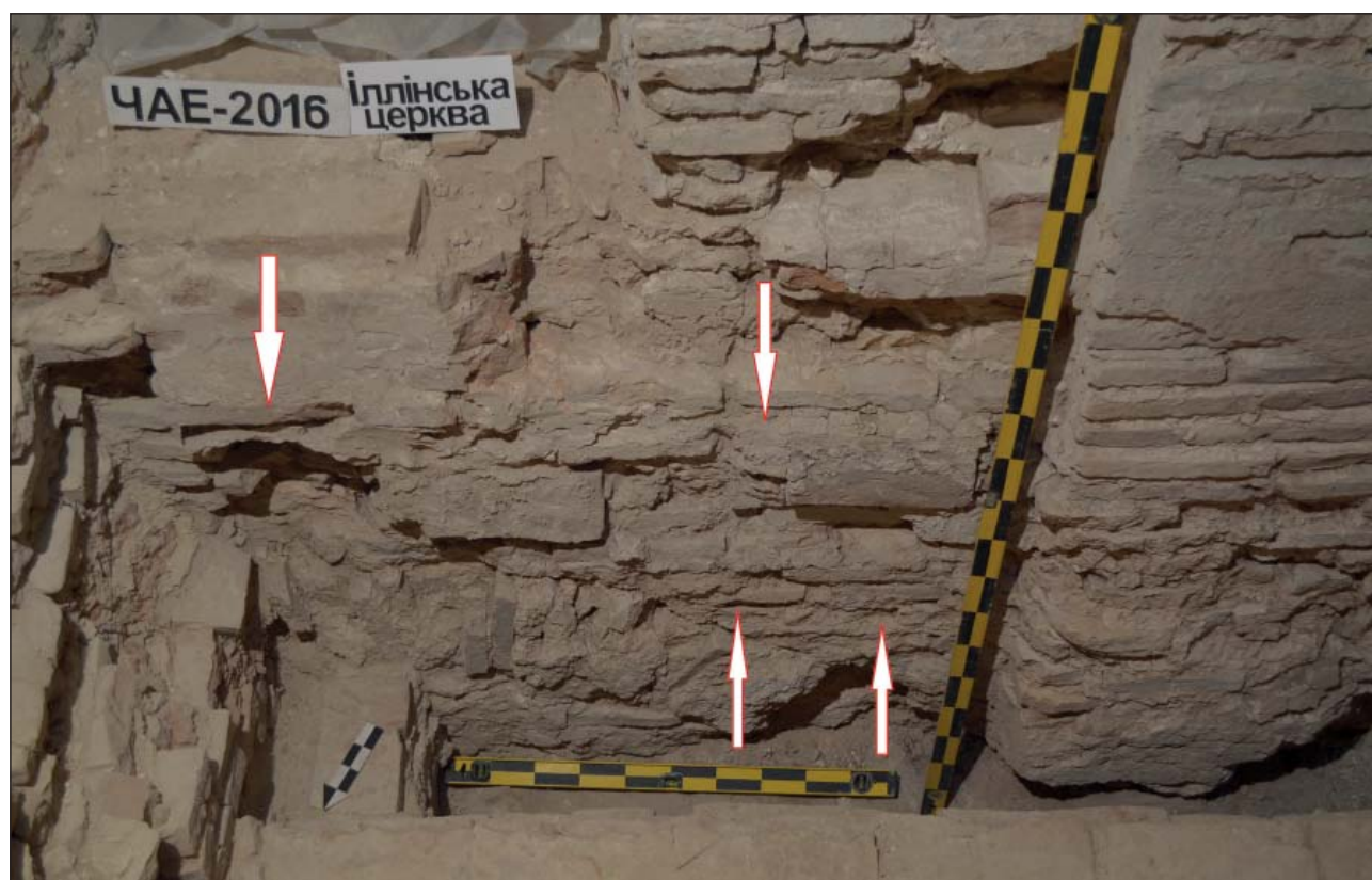
Іл. 12. Ділянка стіни Іллінської церкви під порталом на хори. Нижня розвантажувальна арка; стрілочками позначено сліди прилягання дерев'яних конструкцій. Світлина 2016 р.
