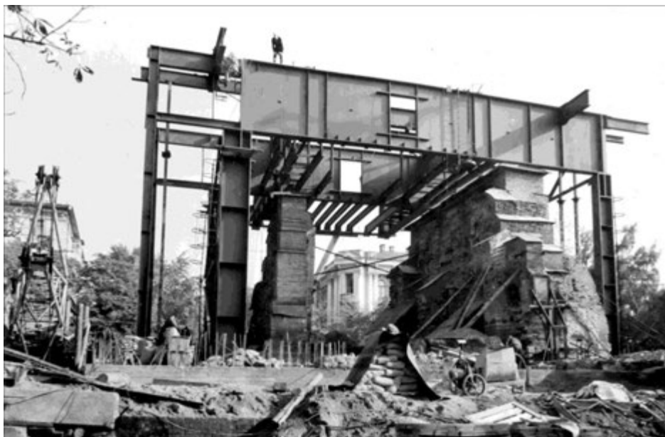
Іл. 12. Будівництво павільйону над залишками Золотих воріт. Світлина Л. Гончара. 1981 р. https://pastvu.com/p/2224670
