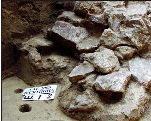
Іл. 15. Залізистий пісковик та червоний кварцит у фундаменті «Південного палацу». Фото В.К. Козюби. 2005 р.
