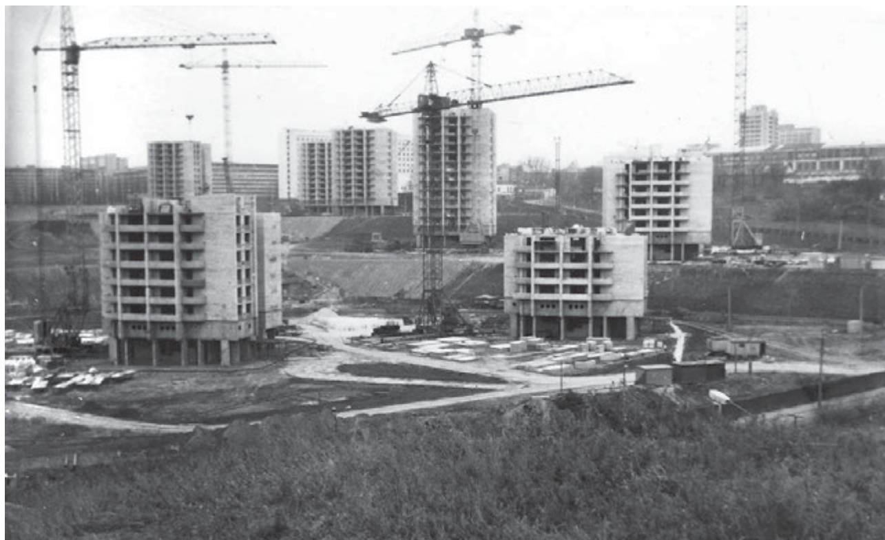
Іл.6. Початок будівництва по вул. Старонаводницькій, у «Царському селі». На задньому плані – вежа № 4. Знімок із західної частини верхнього плато Андріївського люнета. 80-ті рр. XX ст. Світлина Ю. Писаренка
